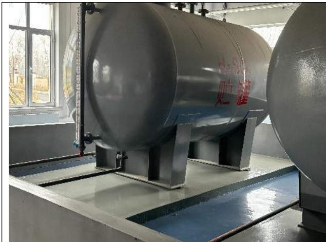
硫酸储罐及围堰
