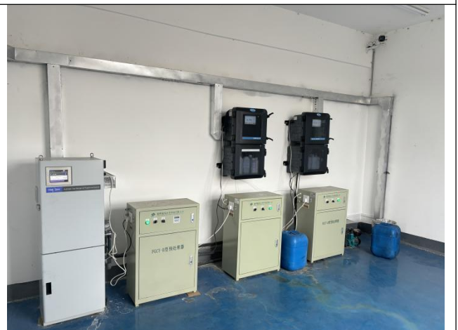
出水在线监测设备（位于污水厂一期工程内）
