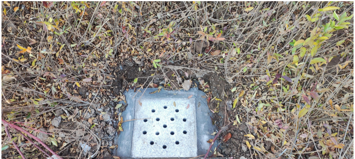
雨水管网及雨水收集口
