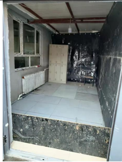
医疗废物暂存间
