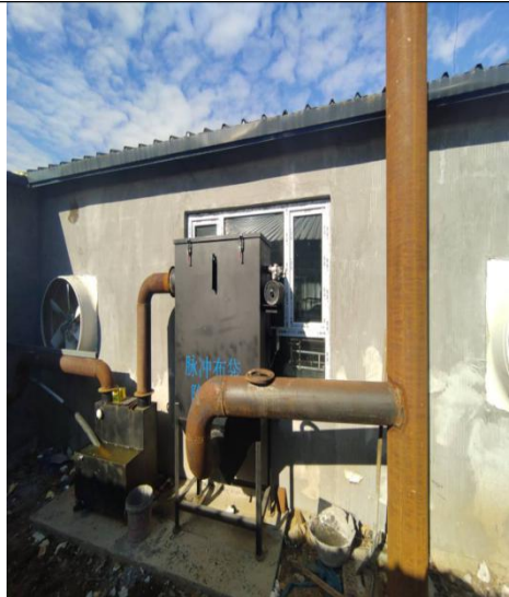
锅炉布袋除尘器
