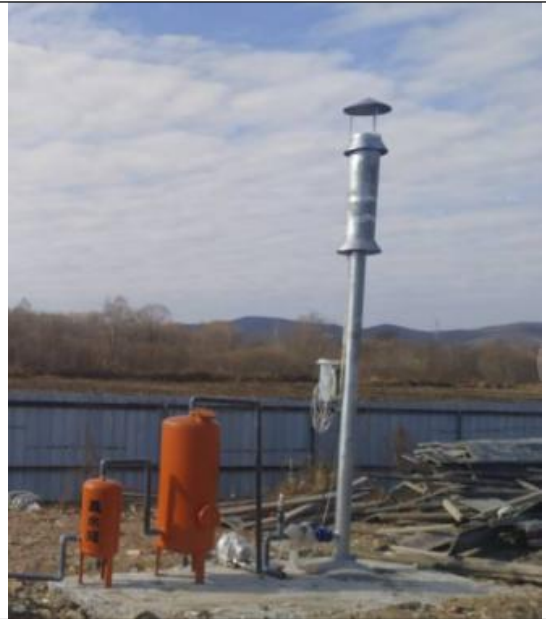
火炬燃烧装置
